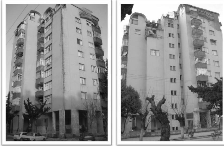
Şekil 1 – Binanın Güçlendirilmeden Önceki Görüntüsü (Tan, M.T., 2009, "Orta-Katlı Bir Betonarme Binanın Lifli Karbon Polimerleri Kullanılarak Güçlendirilmesi: Gerçek Hayattan Bir Uygulama", Yüksek Lisans Tezi)
